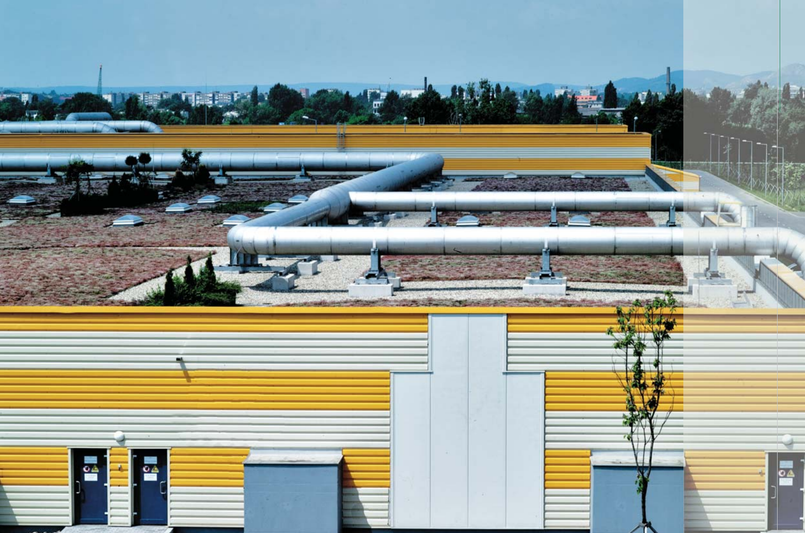
Technológia légvezeték a biológiai műtárgy tetején
