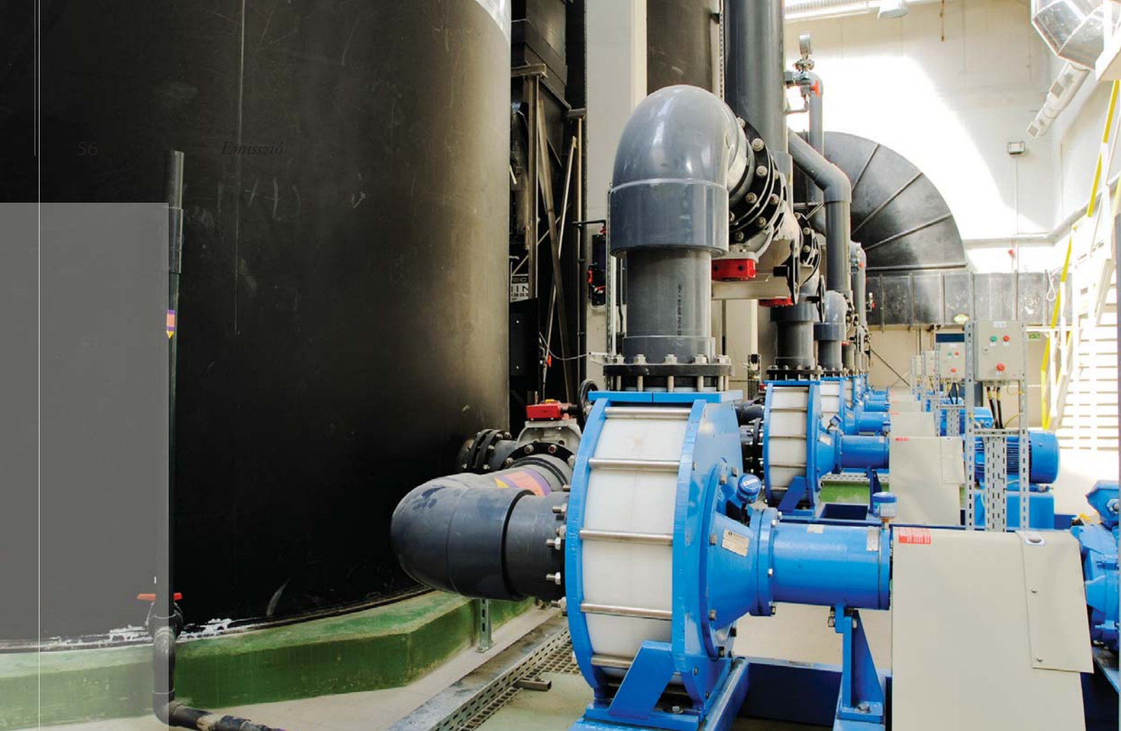
A kémiai szagtalanító műtárgy vegyszervivattyúi
