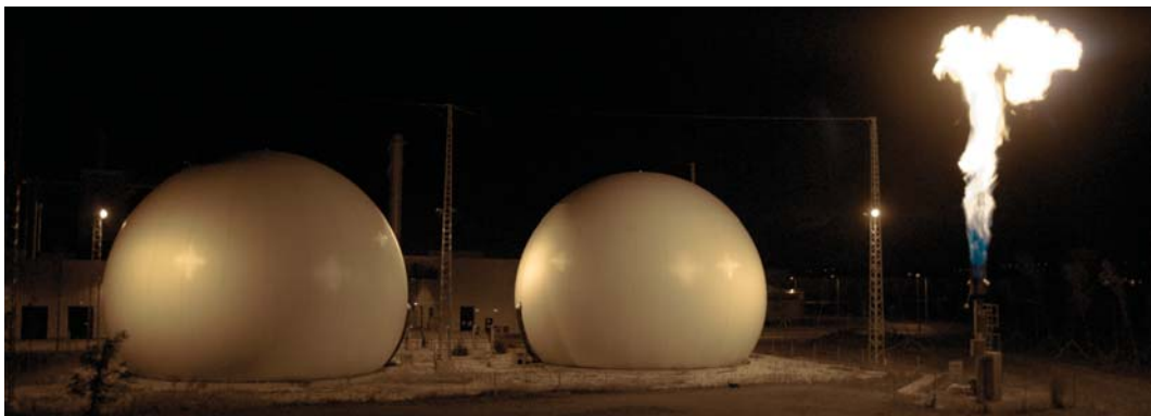
Biogáz tartály és a biogáz fákllya teszt közben
